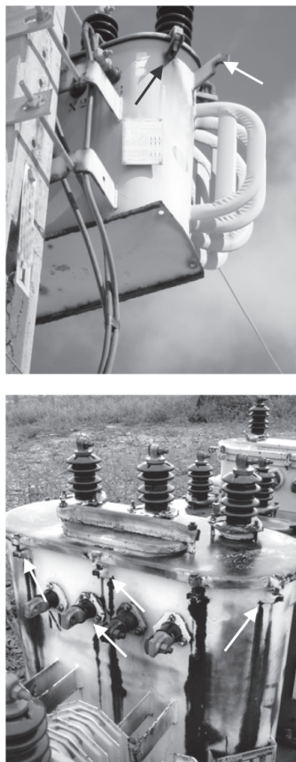
Figura 5. Transformadores da rede de distribuição com problemas de corrosão generalizada no tanque de óleo mineral e nas aletas de refrigeração. A seta está destacando ponto de vazamento de óleo do tanque
