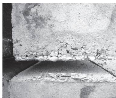
Figura 8. Falhas de concretagem “bicheiras” em poste de concreto tipo duplo T
