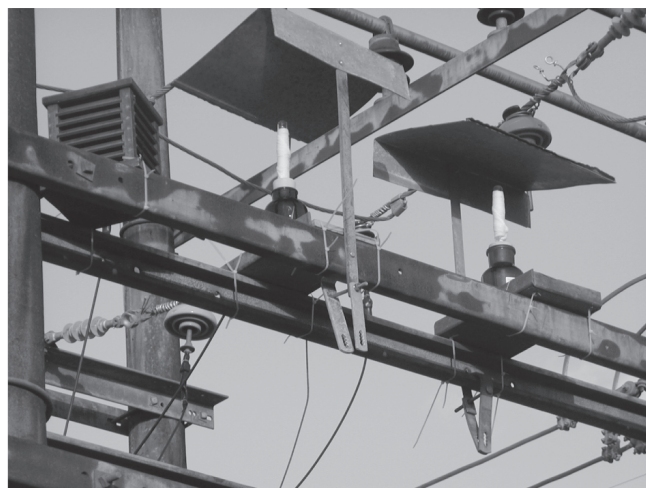
Figura 1. Coletores instalados na SE_Paripe: a) de cloretos (velas brancas); b) coletor de sulfato (instalado no interior da caixa de madeira em treliça)
